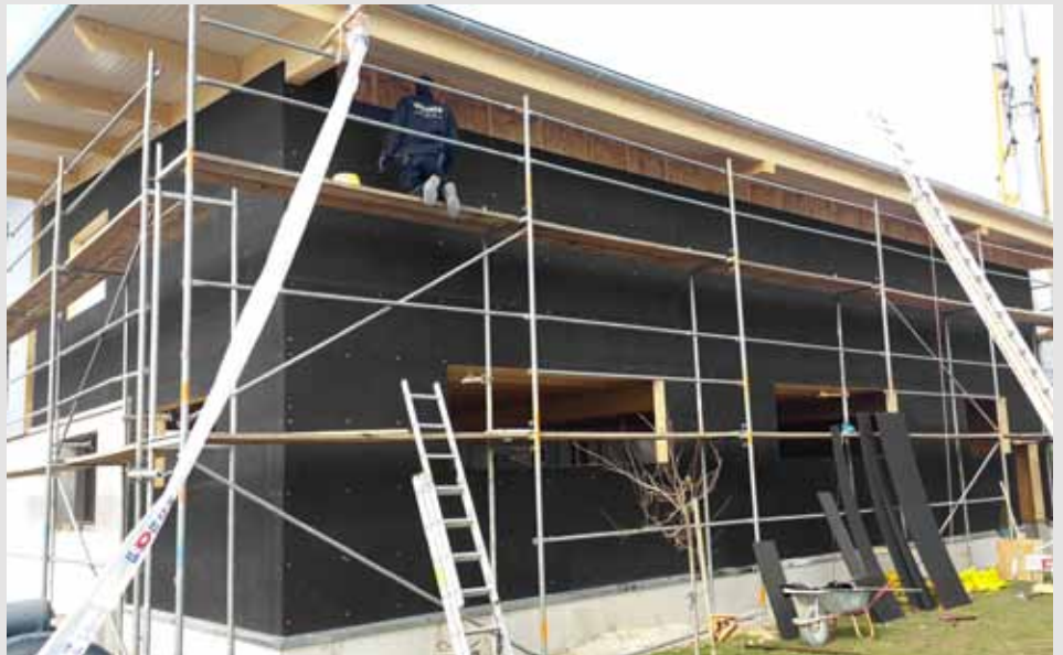
Die fertige Unterkonstruktion für die vorgehängte Fassade: STEICO universal black auf Holzständerwerk
